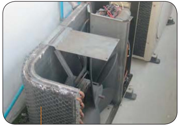
แผงท่อระบายความร้อนของเครื่อง ปรับอากาศแบบแยกส่วนจะอยู่ในตู้ Condensing Unit นอกบ้าน
